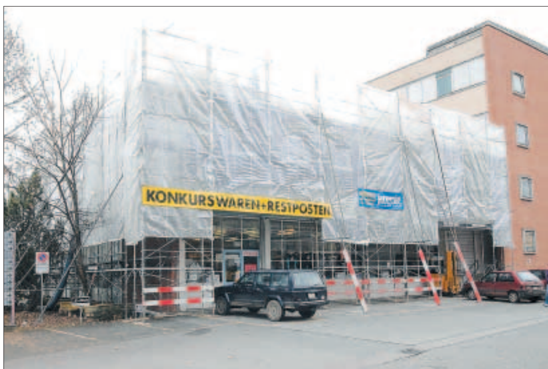
Hinter dem verhüllten Gebäude an der Seestrasse wird intensiv saniert und umgebaut. In die ehemalige Schlossbergschule ziehen im September 2004 die Elektriker ein.
